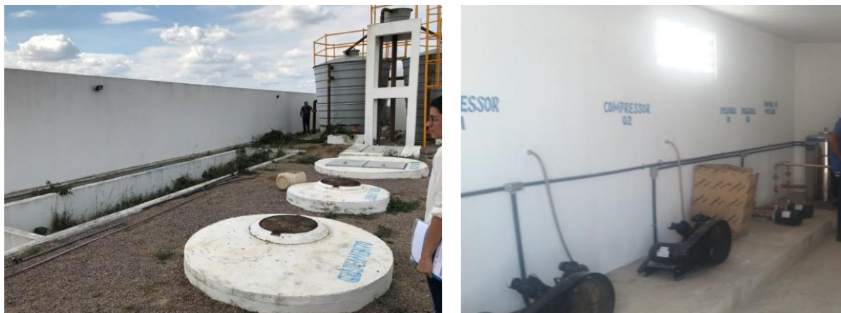
Figura 53 – Estação de Tratamento de Esgoto – Lajedinho/BA
