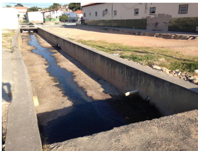
Figura 58 – Lançamento direto de esgoto in natura no Rio Saracura – Lajedinho/BA
