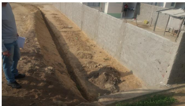
Figura 61 – Obras de drenagem inacabadas na Sede municipal de Lajedinho/BA
