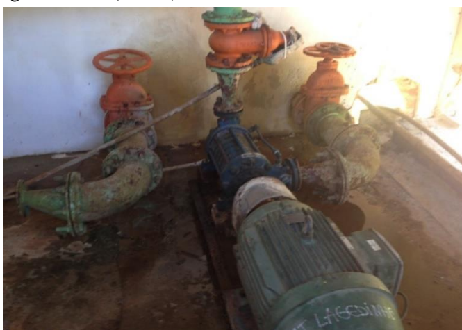
Booster da localidade de Catinga
