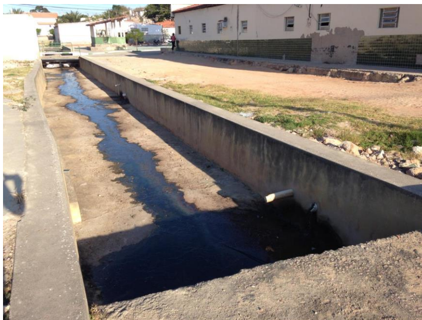
Figura 70 – Contribuições de esgoto sanitário no canal de drenagem urbana em Lajedinho/BA
